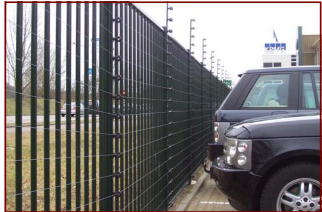
Stromzaun APS-System an Stabzaun
