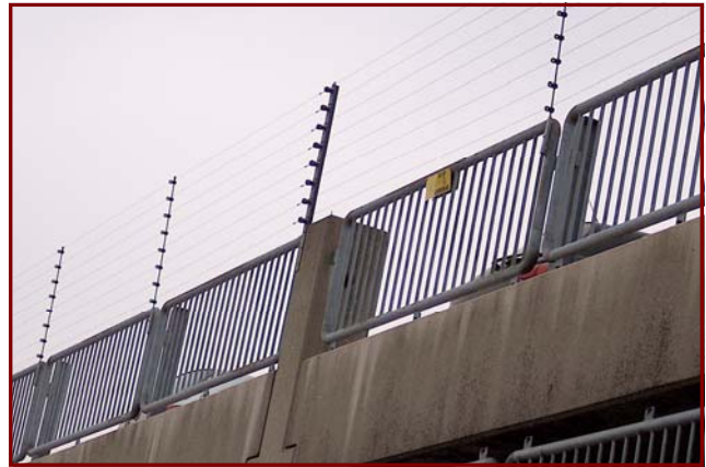
Stromzaun APS-System als Brückenschutz
