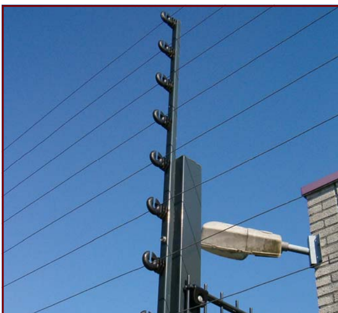
Stromzaun APS-System an Zaunanlage
