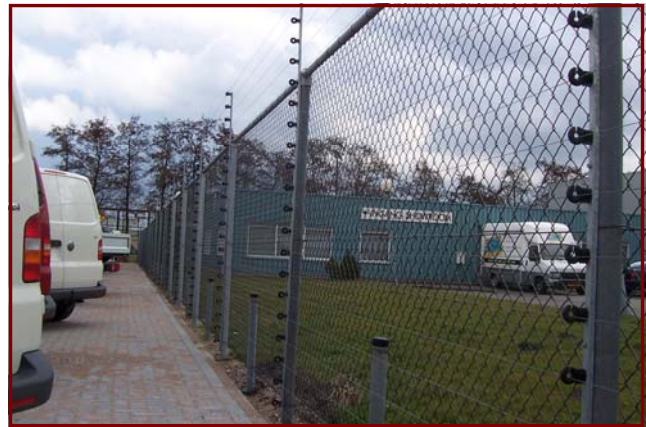
Stromzaun APS-System an Maschendrahtzaun
