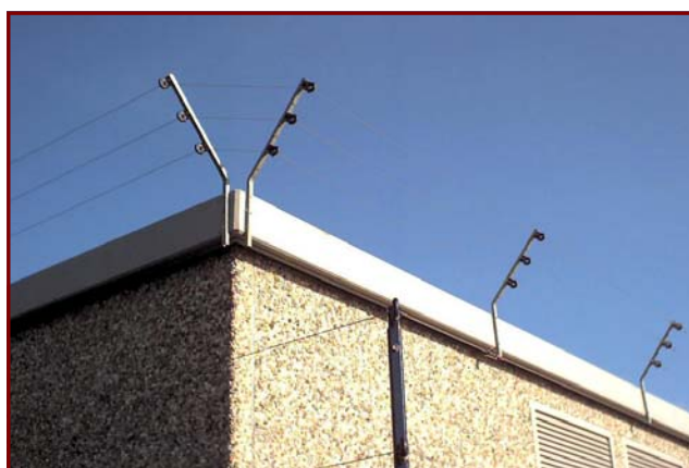
Stromzaun APS als Gebäudesicherung
